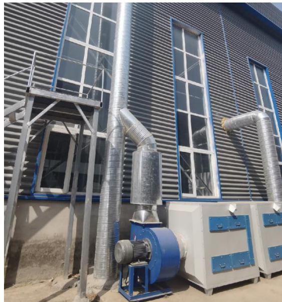
图 3-1 废气治理设施现场图
