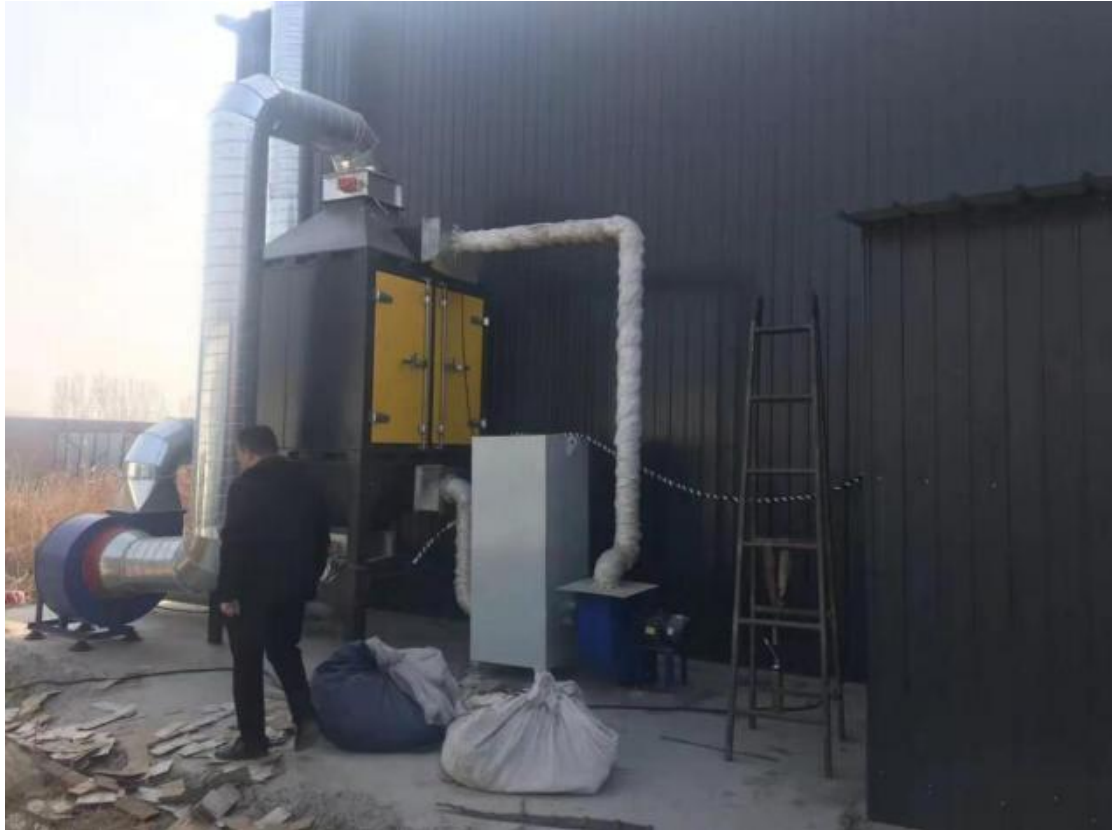
图 3-1 废气治理设施现场图
